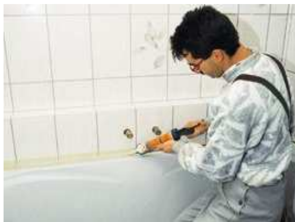
Эластичное уплотнение швов с помощью PCI Silcoferm VE; цветовая гамма герметика соответствует цветовой гамме раствора для затирки швов.
